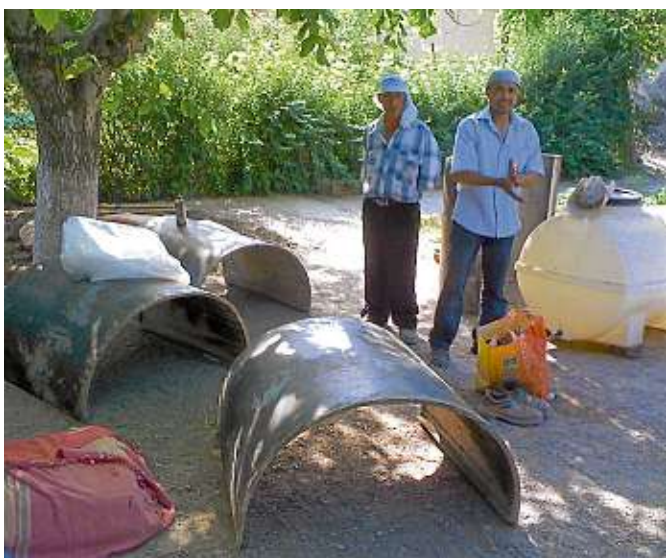
Arbeiter bauten einen Wassertank für das Elternhaus von Nigora Fißmer. In der Stadt, aus der sie stammt, gibt es im Sommer oft kein fließendes Wasser.
